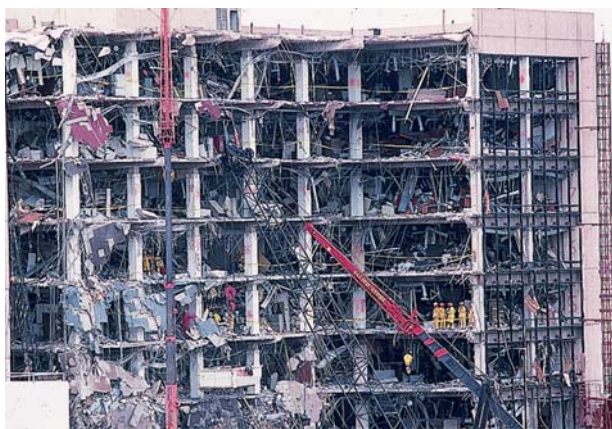
El edificio Alfred P. Murrah después de la fatal explosión ocasionada por una bomba de nitrato de amonio.
