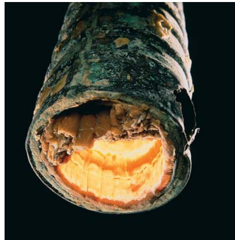
Los depósitos de los calentadores casi obstruyen por completo esta tubería de agua caliente. Estos depósitos están compuestos en su mayor parte por \text{CaCO}_3 y un poco de \text{MgCO}_3 .
