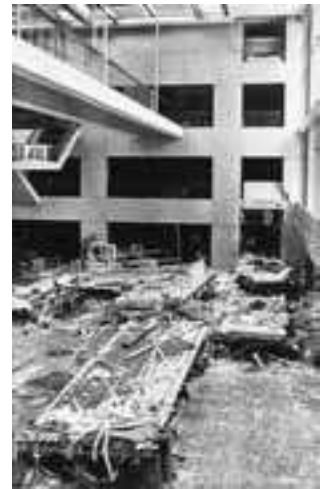
FIGURA 9-1 Paso peatonal elevado que se vino abajo en un hotel de Kansas City en 1981. En el ejemplo 9-12 se considera cómo un simple cálculo físico pudo haber evitado la trágica pérdida de más de 100 vidas.
